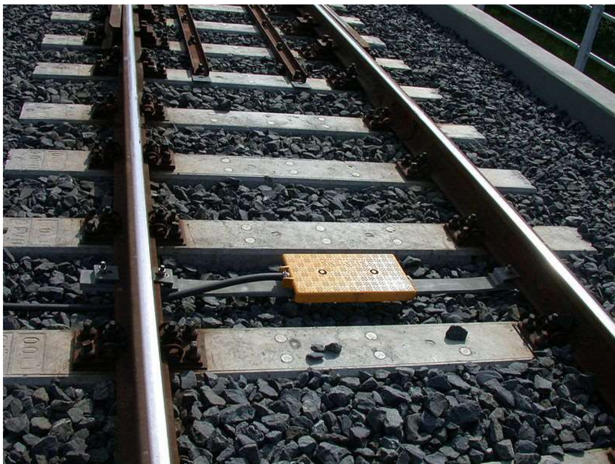
Рисунок 2.1 – ETCS – "Євробаліза" трансивер, встановлений між рейками, забезпечує інформацію про поїзда ETCS
