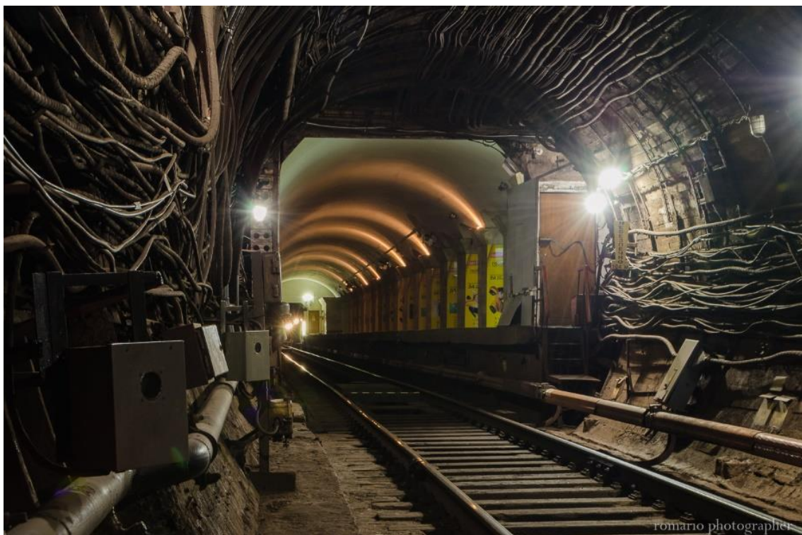
Рисунок 3.2 – Колійні пристрої ДПКПТ, що розміщені в тунелі біля торця платформи станції «Майдан Незалежності» (на фото ліворуч закріплені на обрамленні тунелю)
