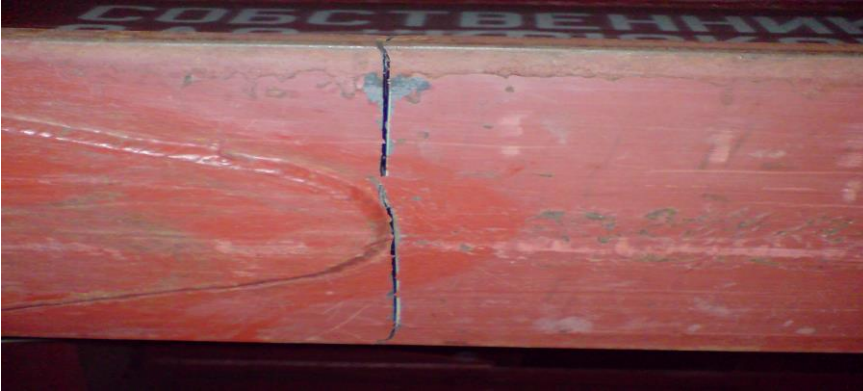
Рисунок 1.14 – Тріщина на зварному шві накладки підсилення бічної балки
