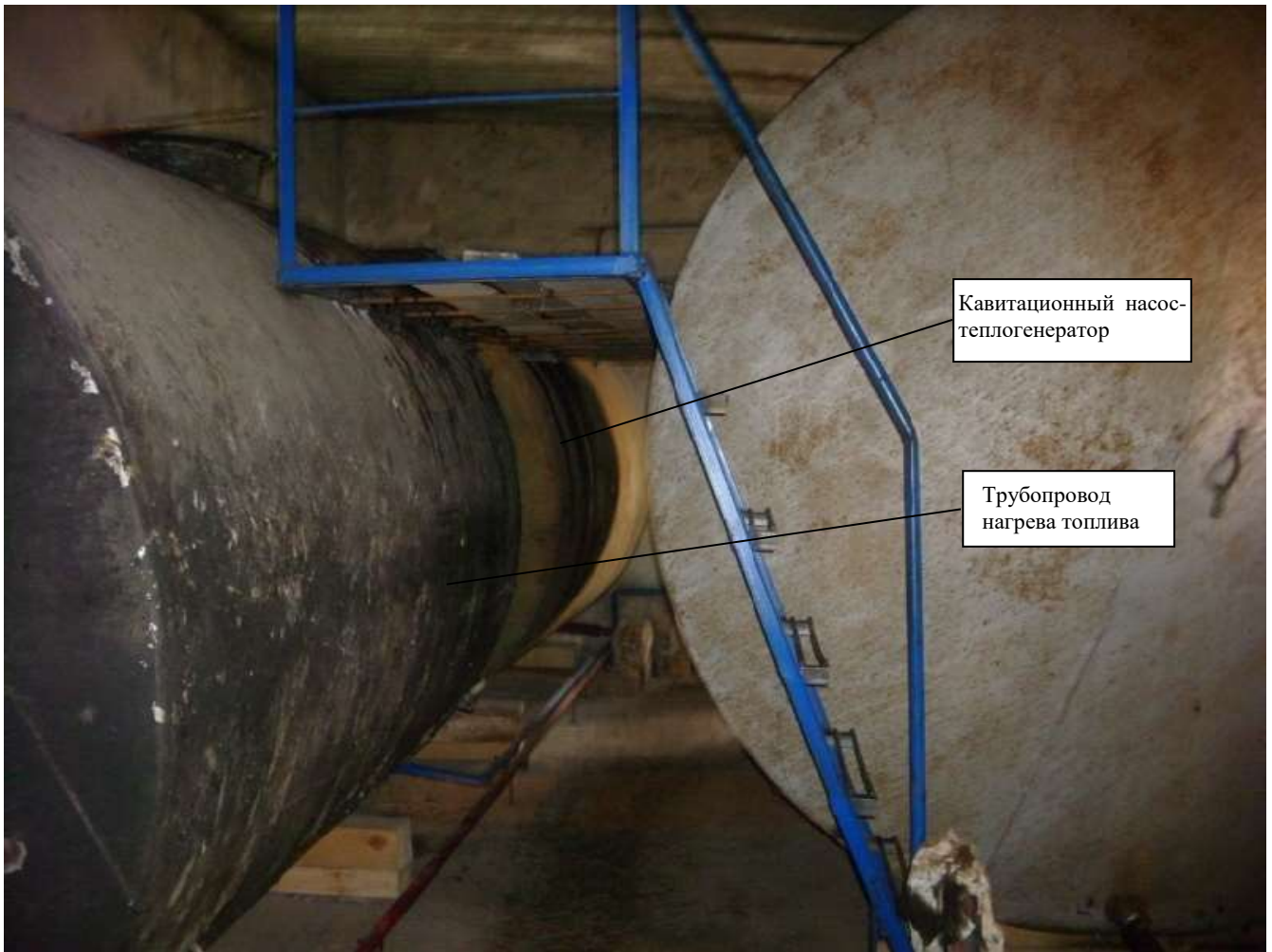
Рисунок Б.8 – Склад готової продукції, що обігривається кавітаційним насосом-теплогенератором (під цистернами проходять трубопроводи нагрівання палива)
