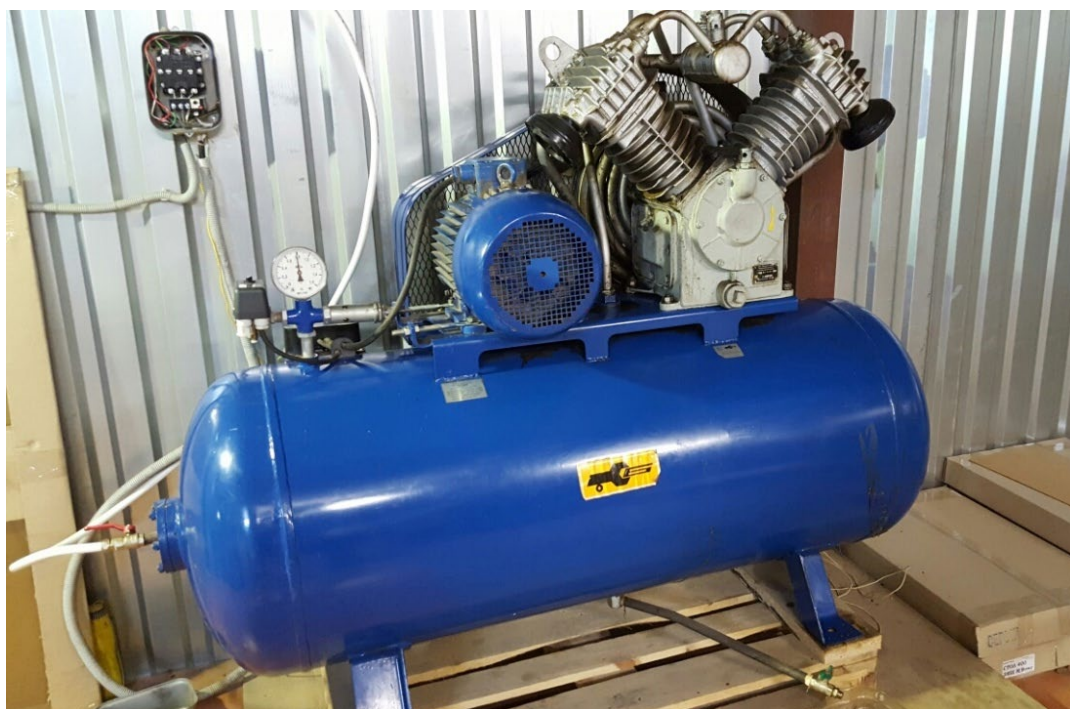
Рисунок 4.11 – Компресорна установка S416M
